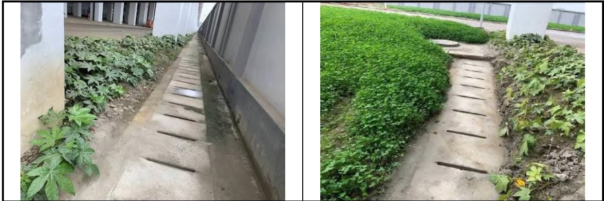
插图 3.5.2-57 车辆段与主变工程区（回龙停车场排水沟及景观绿化）
